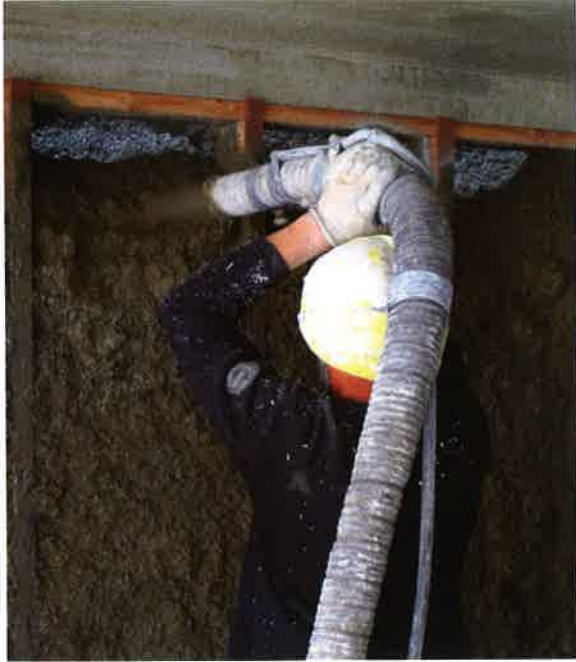
Le béton de chanvre est projeté du bas vers le haut entre les montants de l'ossature bois.
